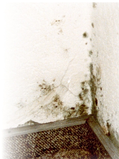
Abb. 5: Wegen der geringeren Dichte von tragenden Böden und Decken entstehen besonders dort Wärmebrücken. Bei fehlender Belüftung bildet sich zuerst Feuchtigkeit und dann Schimmel.
